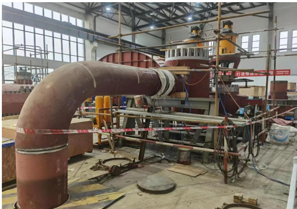
图 4 事故现场情况
