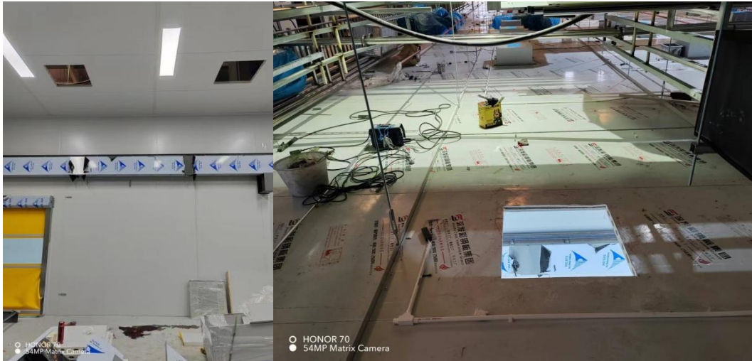
事故现场照片
