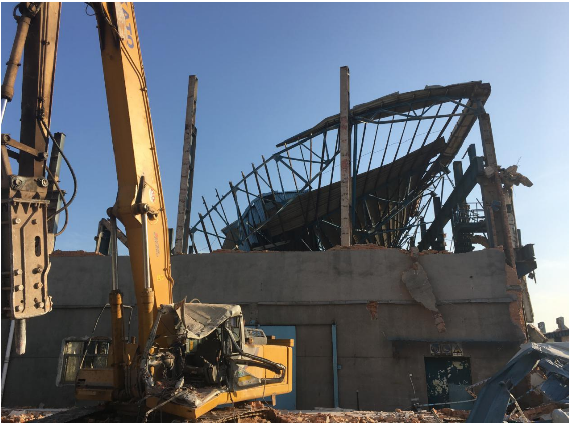
图 2 事故现场图（挖掘机与北侧坍塌墙体）
