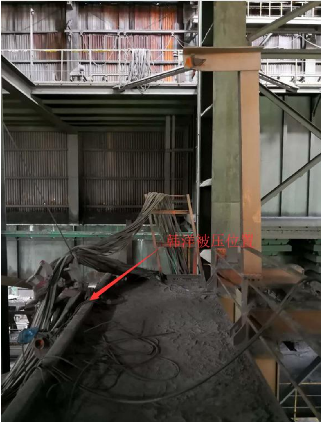
图 2 事故现场图片
